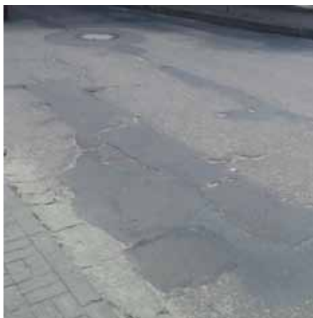
7. Typowe postępujące uszkodzenia nawierzchni asfaltobetonowej
