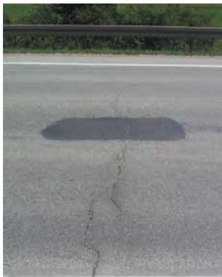
5. Widok typowego uszkodzenia (pęknięcia) nawierzchni asfaltobetonowej
