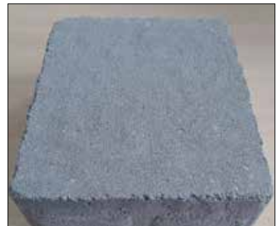
Fot. 6 | Uszkodzenia krawędzi kostki bezfazowej
