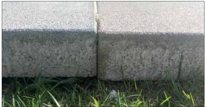
Fot. 5 | Tolerancje wykonania betonowych płyt brukowych
